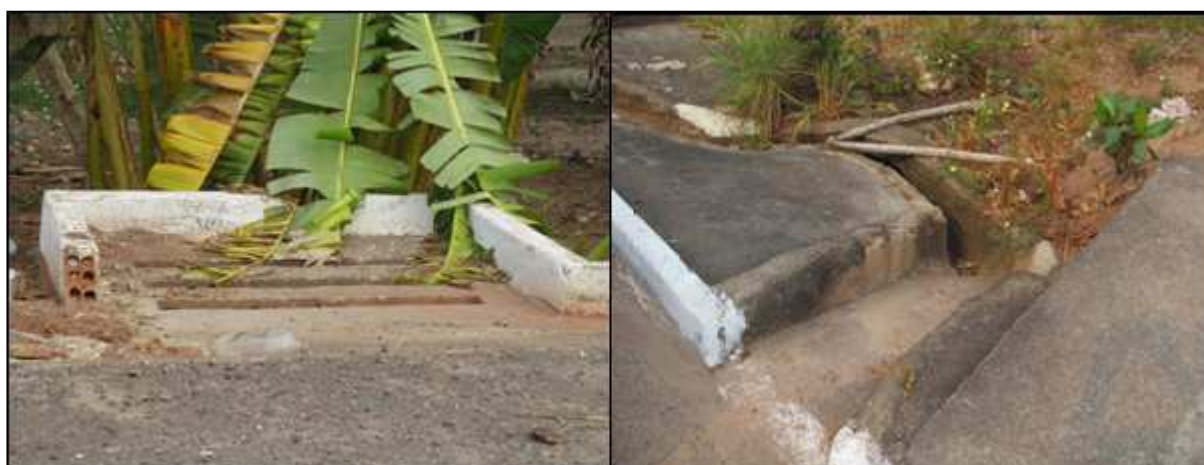
Foto 2.3 – Sistema de Drenagem no município de Pequizeiro-TO
