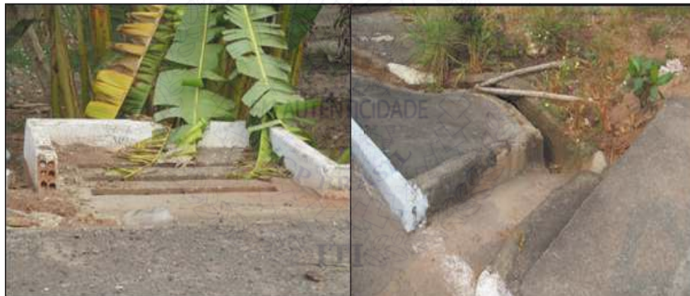
Foto 2.3 – Sistema de Drenagem no município de Pequiizeiro-TO
